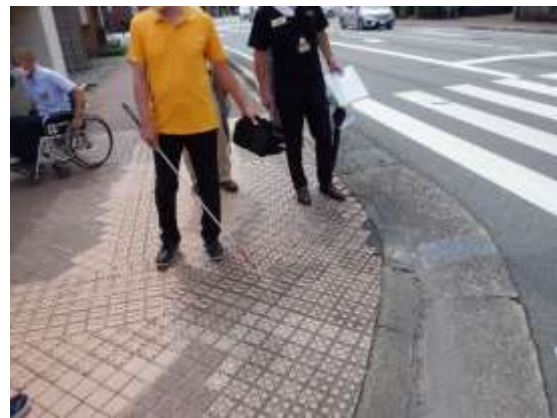
歩道（鳥羽松阪線） 視覚障がい者誘導用ブロックの色が舗装と 同色で分かりづらい。
