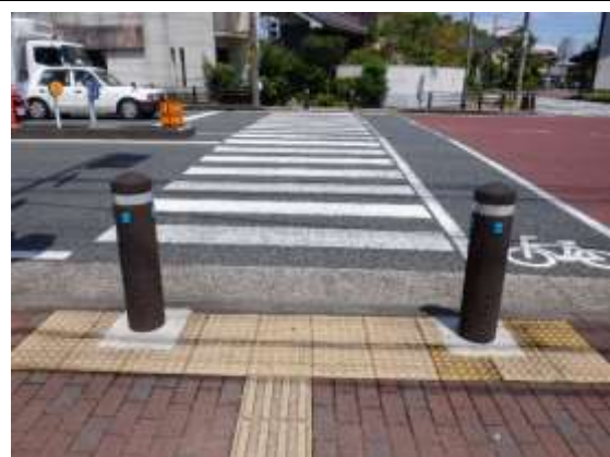
歩道（伊勢磯部線：県-17） 歩行者防護用ボラードが視覚障がい者誘導 用ブロックに食い込んで設置されている。
