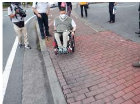
歩道（伊勢南島線） 凸凹、ブロックの隙間、ひび割れなどが生じ ている。
