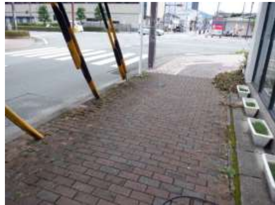
歩道（本町宮川堤線：市-1） 視覚障がい者誘導用ブロックが設置されていない。
